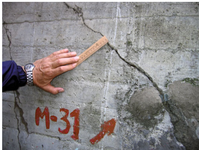
Рис. 2. Трещины в подпорной стенке над зданием Чиркейской ГЭС от воздействия крипа со стороны потенциально оползневого левобережного откоса
