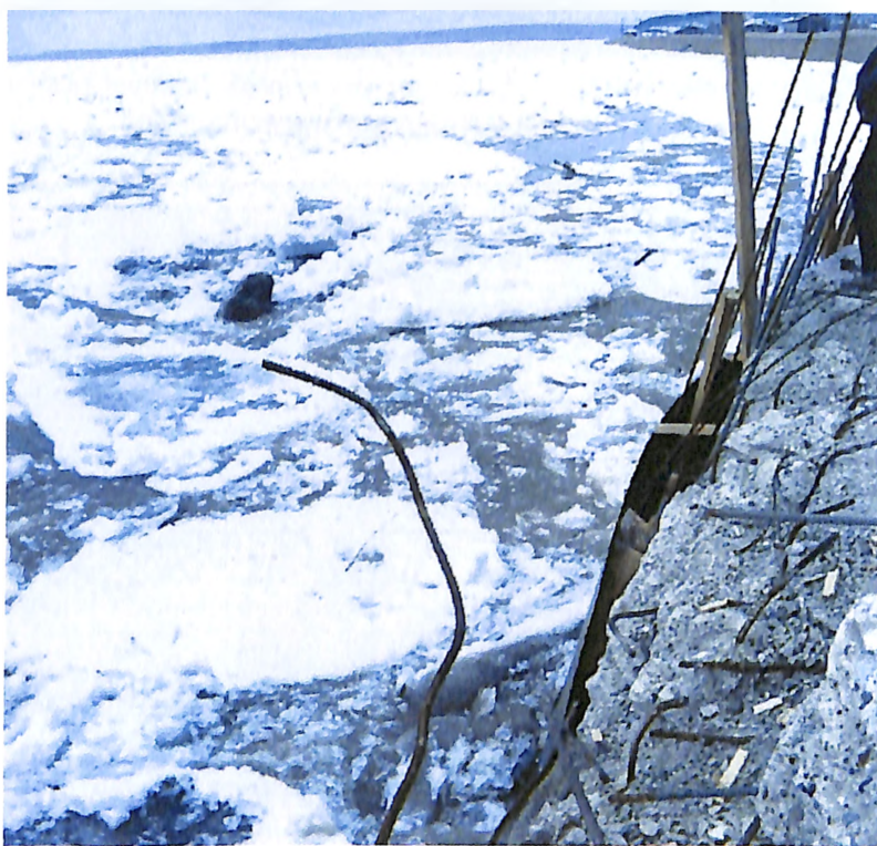
Головная часть бетонной стенки причала повреждается ледоходом на р. Лене. (к статье Зайцева А.А.)
