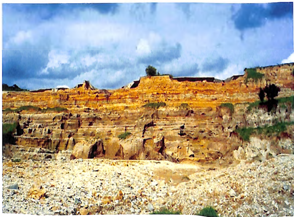
Вид полуразрушенной грунтовой плотины со стороны нижнего бьефа, (к статье Беликова В.В.)
