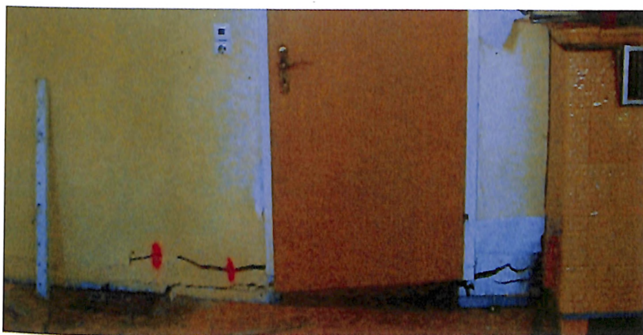
Разрушение стены, построенной на насыпном грунте.
