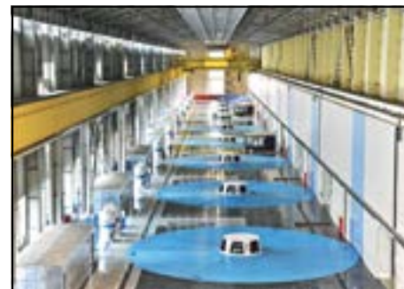
Подпись: Машинный зал Богучанской ГЭС
