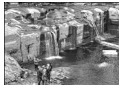
Разрушения в водобойном колодце Саяно-Шушенской ГЭС
