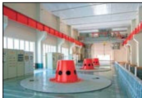
Машинный зал Гунибской ГЭС
