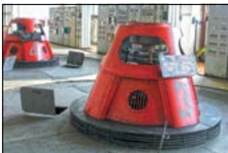
Новый машинный зал Гергебильской ГЭС
