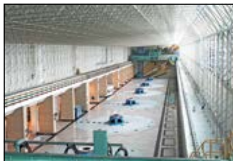
Машинный зал Бурейской ГЭС
