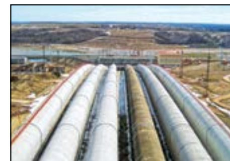
Напорные водоводы Загорской ГАЭС
