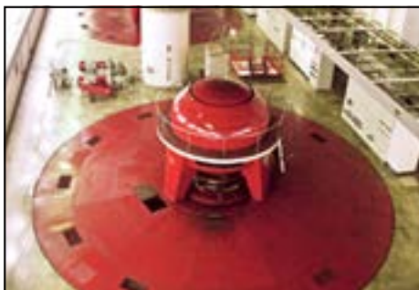
Машинный зал Колымской ГЭС
