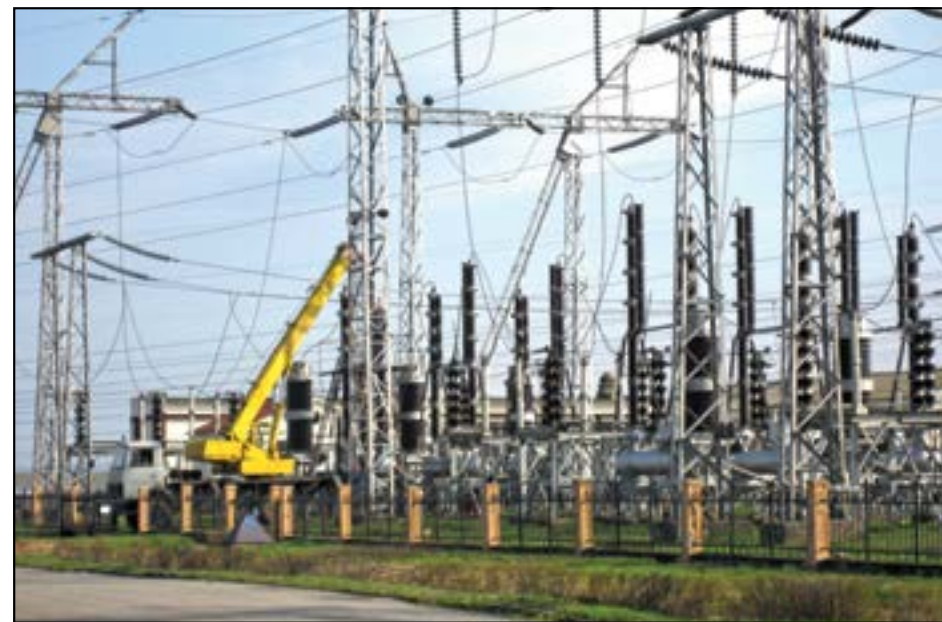
Оборудование открытого распределительного устройства
