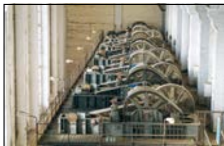
Механизмы затворов Угличской ГЭС
