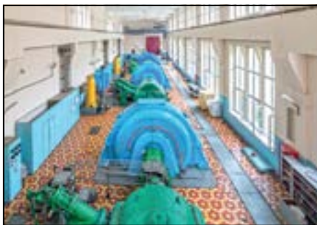
Машинный зал Гизельдонской ГЭС
