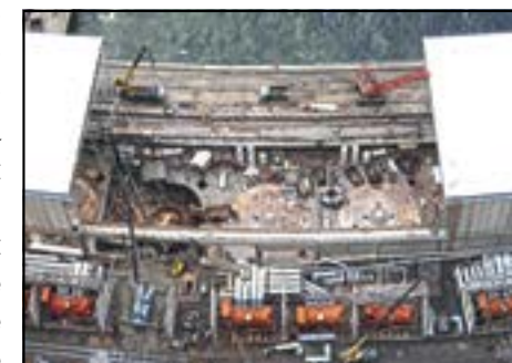
Последствия аварии на Саяно-Шушенской ГЭС
