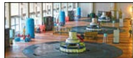
Машинный зал Путкинской ГЭС
