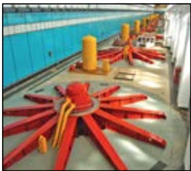
Машинный зал Волжской ГЭС
