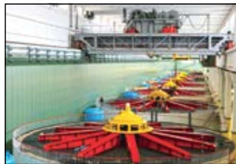
Машинный зал Воткинской ГЭС
