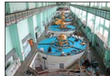
Машинный зал Зейской ГЭС
