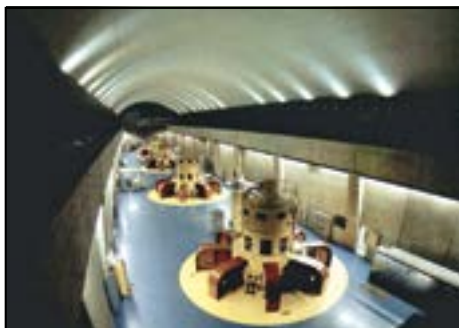
Машинный зал Верхне-Тулумской ГЭС. Фото ТГК-1
