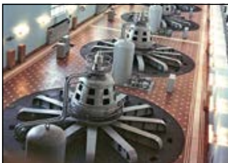
Машинный зал Иркутской ГЭС в 1960-х годах. Фото Алексея Бушкина
