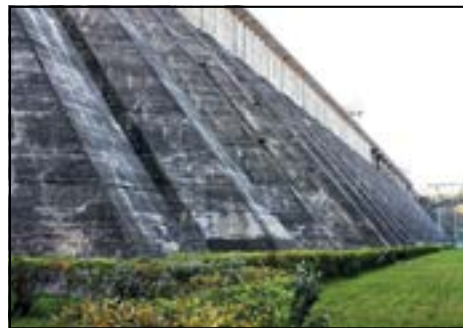
Водоводы Красноярской ГЭС
