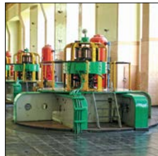
Машинный зал Канакерской ГЭС
