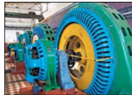
Гидроагрегаты ГЭС Хямекоски. Фото ТГК-1
