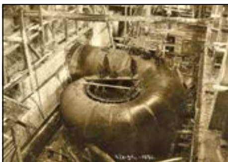
Спиральная камера гидротурбины. Фото ТГК-1
