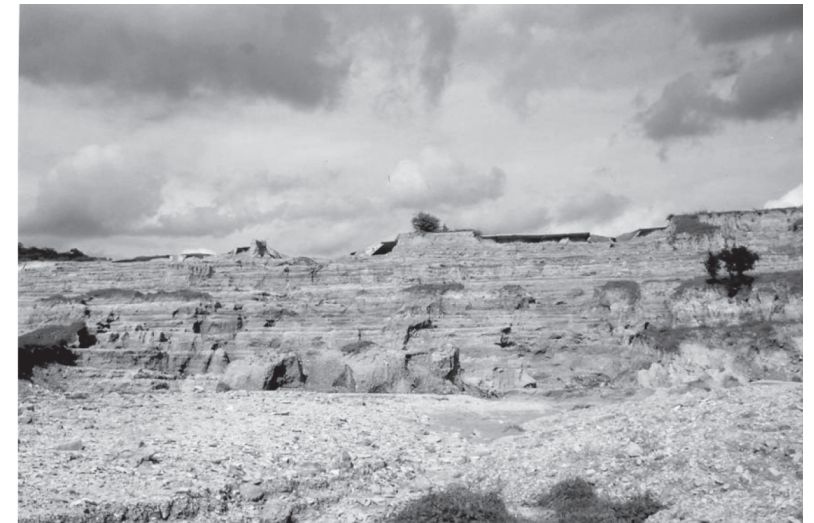
Рис. 2. Повреждение гребня и низового откоса глиняной плотины на р. Дюрсо (высота плотины 24 м, длина по гребню 216 м)
