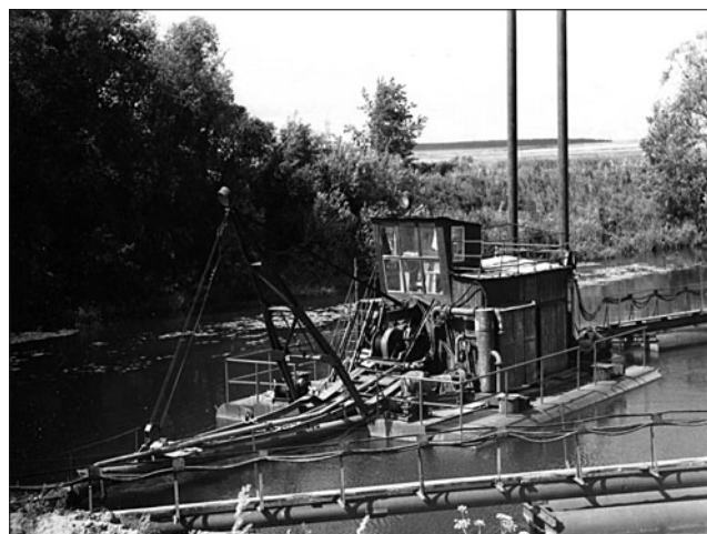
Рис. 6. Земснаряд с грунтовым насосом 10ГрУЛ-8 во время эксплуатации после его подъема и установки дополнительных понтонов по бортам
