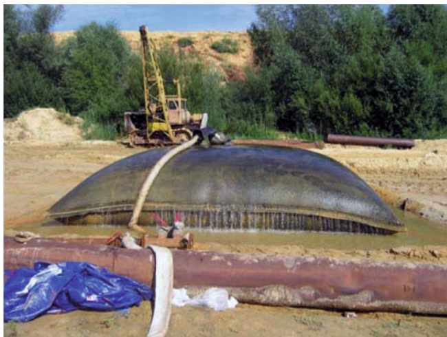
Рис. 8. Запорная арматура на рукавах подачи кондиционированной пульпы
