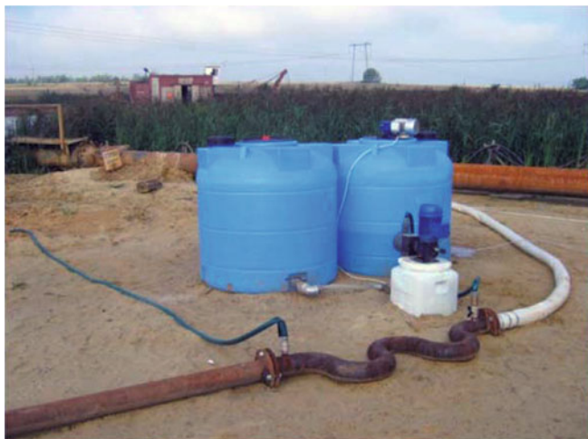
Рис. 5. Состав станции приготовления и дозирования флокулянта для кондиционирования шлама
