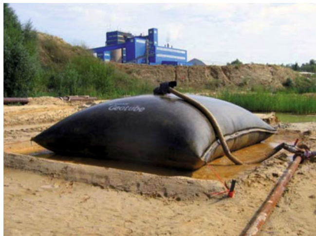
Рис. 6. Запорная арматура на рукавах подачи кондиционированной пульпы
