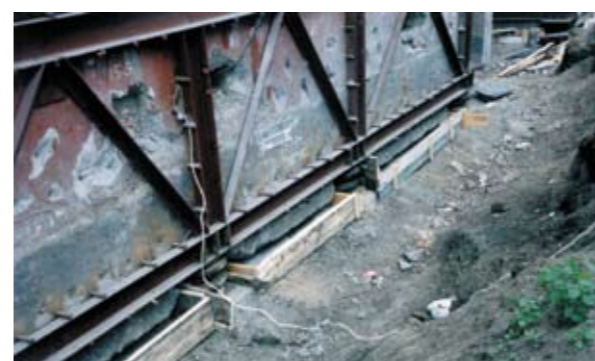
Рис. 8. Регулируемый фундамент со стальным поясом распределения по ферменному типу, г. Белово, Кемеровская обл.
