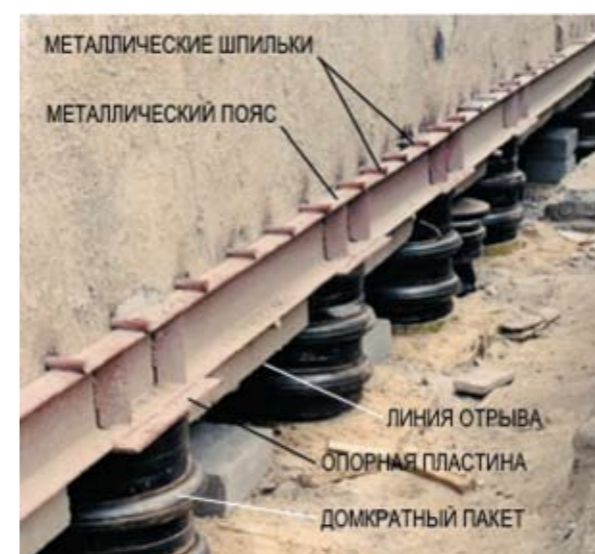
Рис. 6. Конструктивное решение регулируемого фундамента 11-этажного жилого дома в г. Катовице (Польша). Стальной пояс по балочному типу
