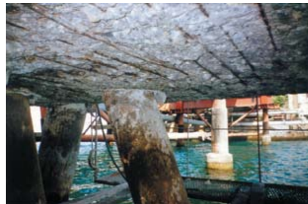
Рис. 1. Нижняя поверхность причала до ремонта
