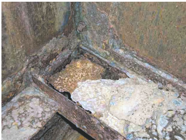
Рис. 5. Общий вид затвора № 10. Пример коррозии металла стрингера
