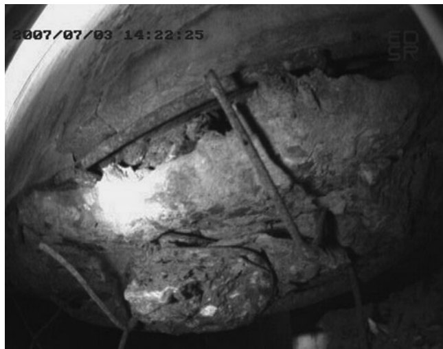
Рис. 4. Вид поврежденной железобетонной конструкции, находящейся в воде
