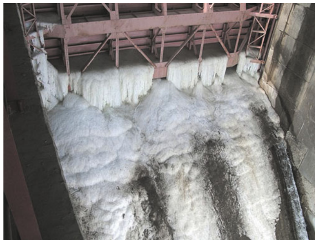
Рис. 6. Состояние затвора водосливной плотины в зимний период
