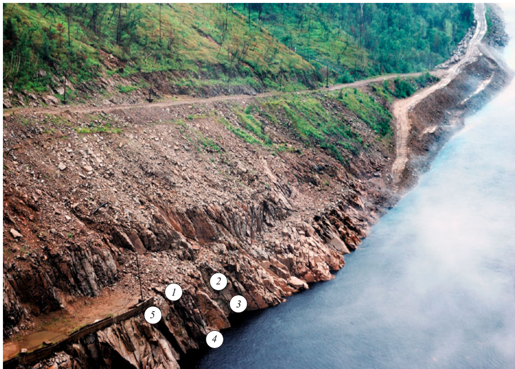
Размыв левого берега в зоне падения отброшенной струи за водосбросной плотиной Бурейской ГЭС
