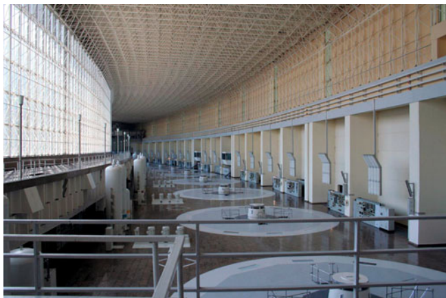
Рис. 4. Саяно-Шушенская ГЭС. Машинный зал
