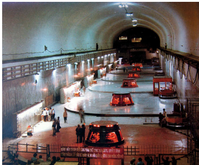
Рис. 5. ГЭС Хоабинь (СРВ). Машинный зал
