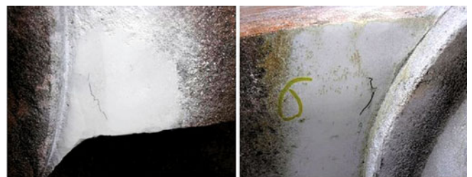
Рис. 4. Дефекты, обнаруженные МПД
