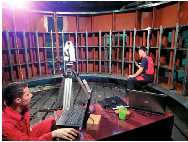
Рис. 7. Разгонка клиньев статора гидрогенератора СВ 448/140 – 18ТВ4 с применением лазерного трекера “Leica AT401”
