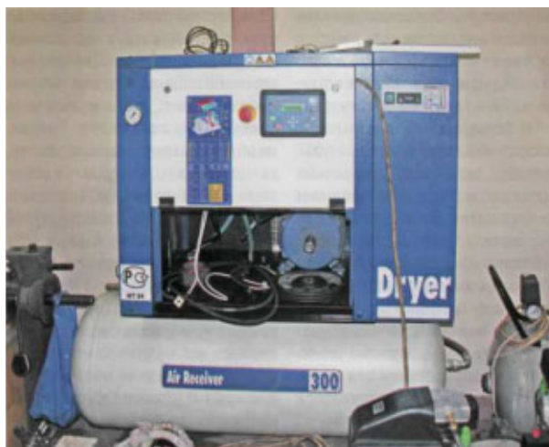
Как всякое оборудование, винтовой компрессор требует технического обслуживания
