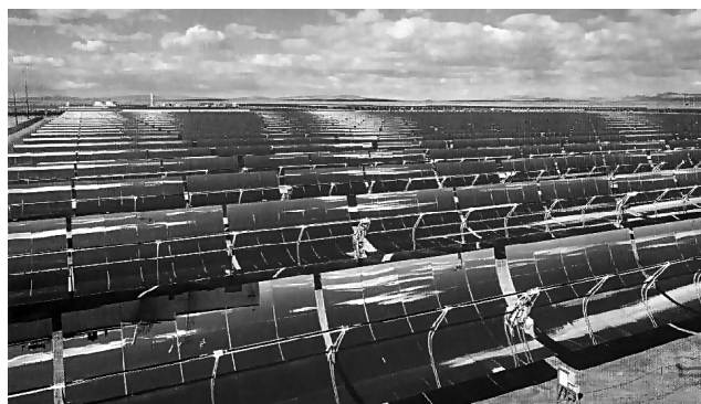
Рис. 1. Солнечная электростанция в США, 1980 г. Источник: Photon International September 2010, p. 18
