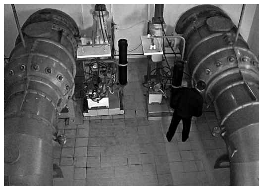
Рис. 4. МГЭС на сбросах ТЭЦ-2, два энергоблока с гидроагрегатами мощностью 130 кВт с S-образной турбиной, Республика Беларусь
