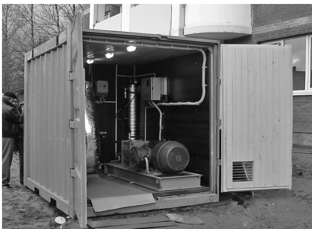
Рис. 1. Стационарный тепловой пункт
