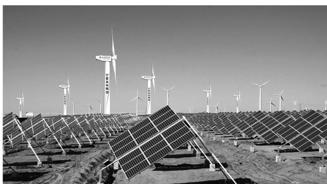
Рис. 3. Солнечно-ветровая электростанция компании NingxiaYinxing Energy CO Ltd мощностью 10 МВт (Китай). Источник: Ningxia Yinxing Energy Co Ltd Presentaion
