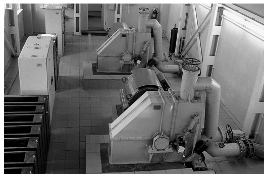
Рис. 2. МГЭС «Джазатор» — два гидроагрегата мощностью по 315 кВт с ковшовой турбиной, Республика Алтай
