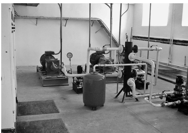
Рис. 2. Блочно-модульный тепловой пункт
