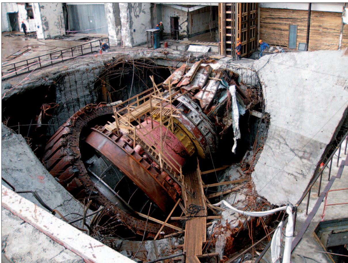
Рис. 4. Повреждение турбины и генератора блока № 2 в результате катастрофы
