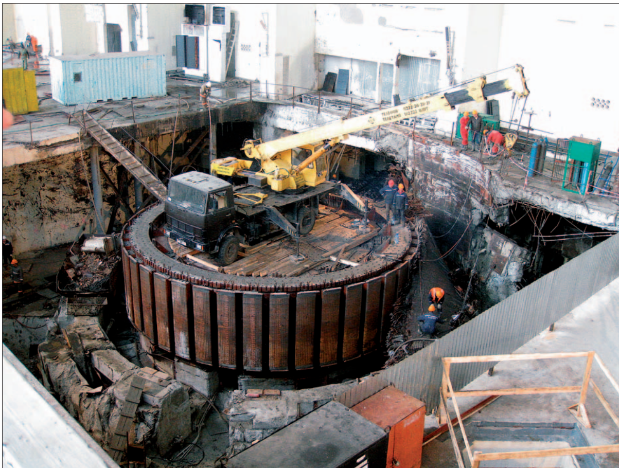
Рис. 5. Повреждение статора генератора агрегата № 7 в результате короткого замыкания при затоплении здания ГЭС
