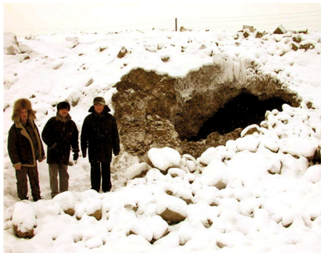
Рис. 2. Грунтовая плотина мерзлого типа на р. Ирелях (г. Мирный, Якутия). Аварийная ситуация, связанная с отказом мерзлотной завесы
