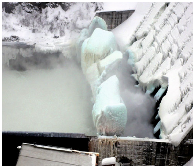
Рис. 9. Наледи, образовавшиеся во время зимней эксплуатации водосброса Саяно-Шушенской ГЭС
