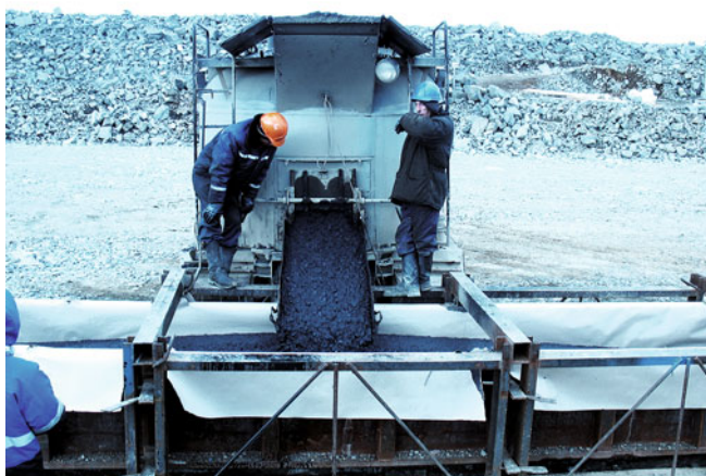
Рис. 5. Заливка асфальтобетона в металлическую опалубку на строительстве диафрагмы каменнонабросной плотины Богучанской ГЭС
