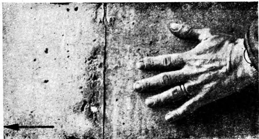
Рис. 9. Кавитационные раковины на шероховато поверхности бетонной стенки (глубина до 0,3 см). Рука приведена для масштаба.
