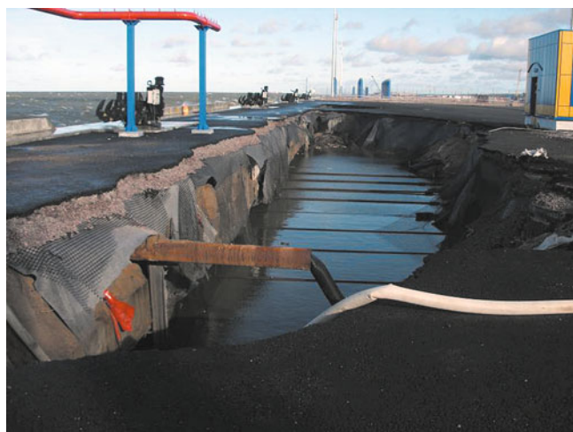
Рис. 2. Провалы грунта перед экранирующей стенкой на причале, подготовленном к эксплуатации
