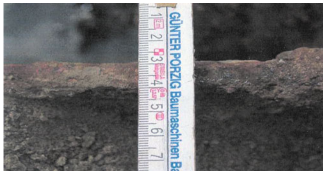
Рис. 10. Измеренная толщина полки шпунта, изъеденной коррозией
