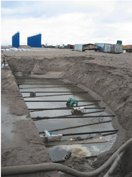
Рис. 3. Провалы грунта на причале в процессе завершения строительства
