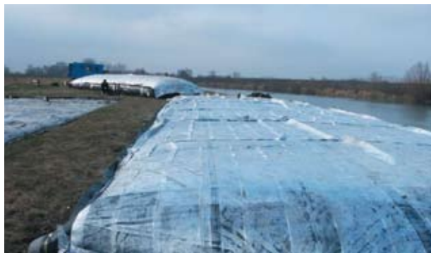
Рис. 3. Гибкая дамба с рабочей высотой 3,0 м, установленная в бассейне р. Кубань
