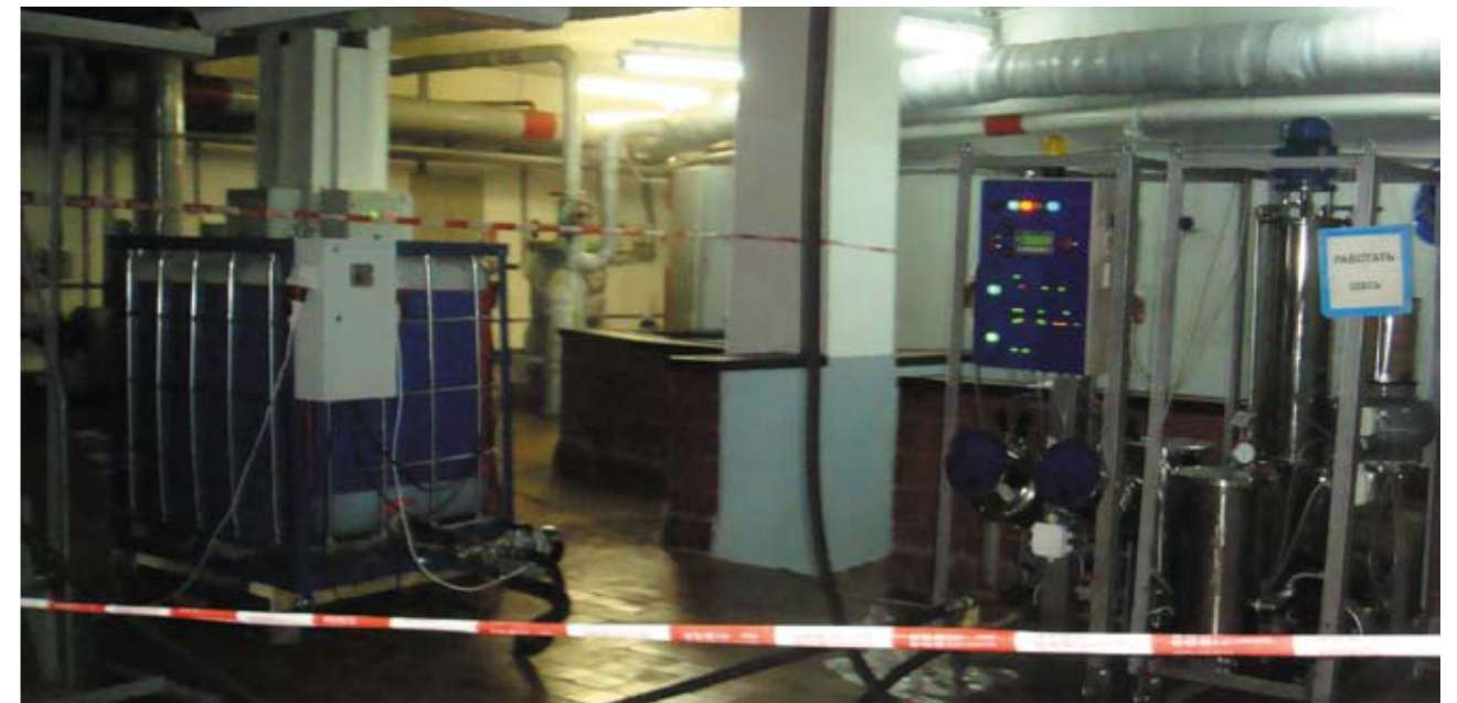
Рис. 4. Комплекс ФОДЖ КФ2-01-1 и реактор РПВП-01 на МГУ Саяно-Шушенской ГЭС им. П. С. Непорожного
