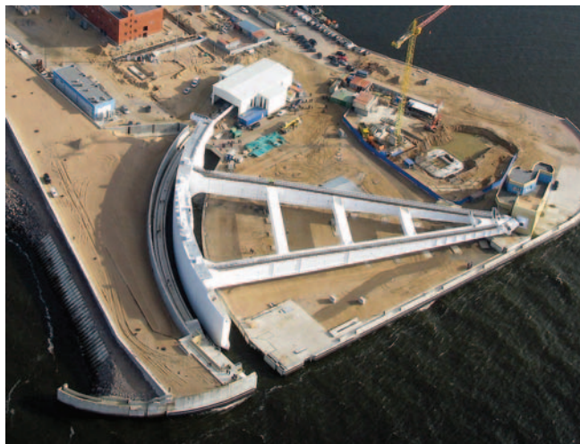
Рис. 16. Комплекс защиты г. Санкт-Петербург от наводнений, судопропускные сооружения С-1, створка плавающего затвора в доковой камере
