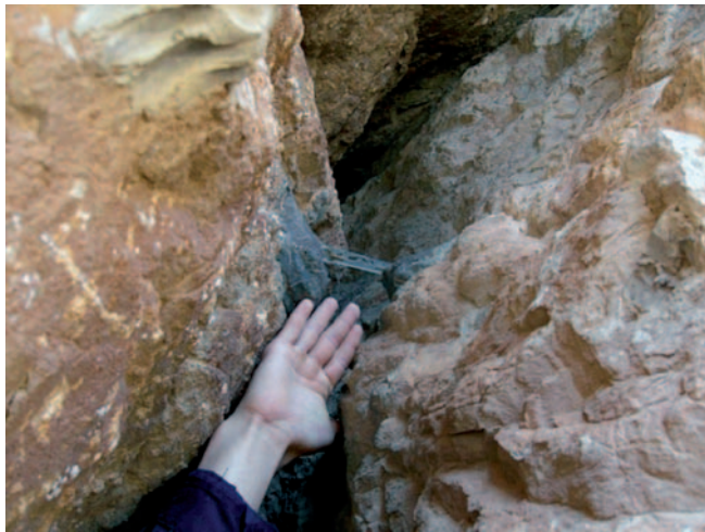
Рис. 9. Стекланный маяк, установленный в 1992 г. по трещине 714
