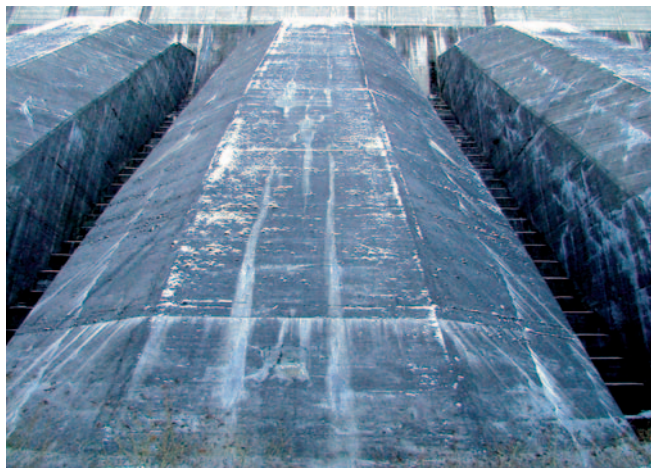
Рис. 3. Красноярская ГЭС. Ступенчатая низовая грань станции-онной плотины: высота ступеней 1,5 м, длина (расстояние между водоводами) — 4,5 м
