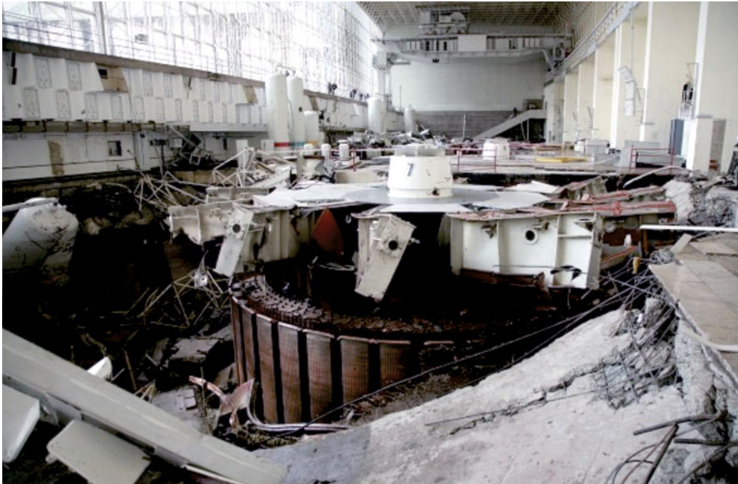
Рис. 3. Генератор 7-го агрегата
