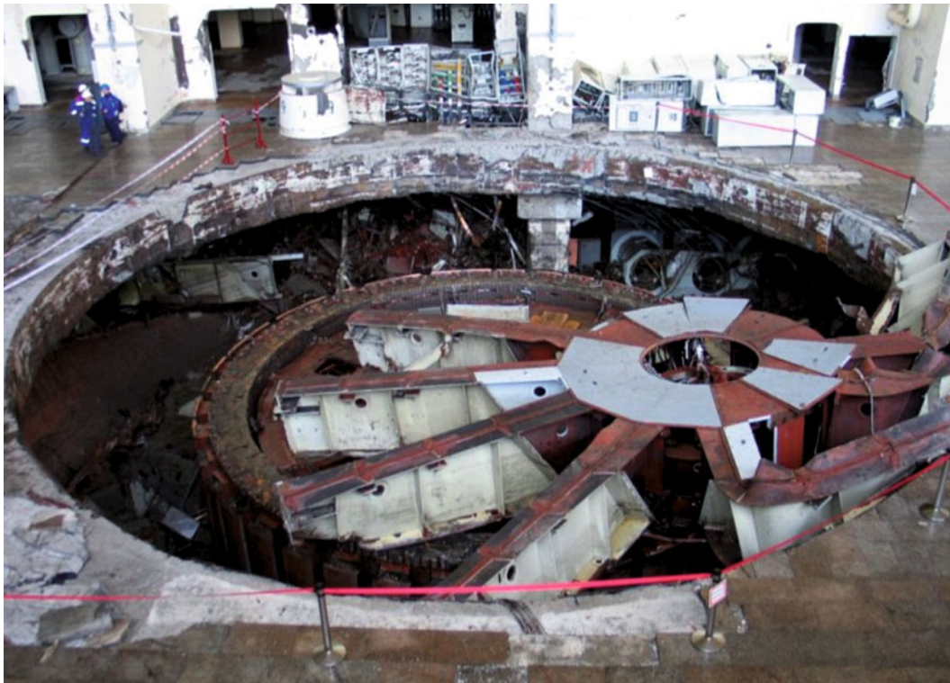
Рис. 5. Генератор 9-го агрегата
