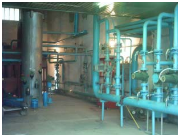
Фото 4. Котельно-распределительный тепловой узел
