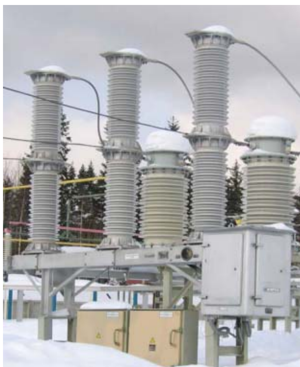
Рис. 2. Элегазовый выключатель ВГТ-110II-40/2500 (110 кВ)
