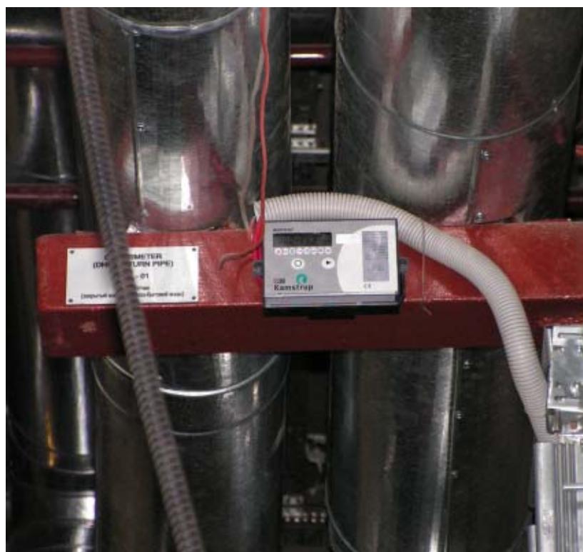
Фото 1. Теплосчетчик Kamstrup на ИТП
