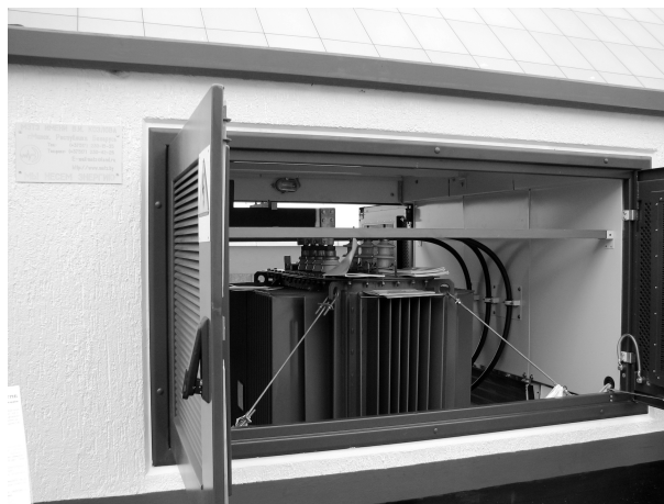
Рис. 1. Современная трансформаторная подстанция
