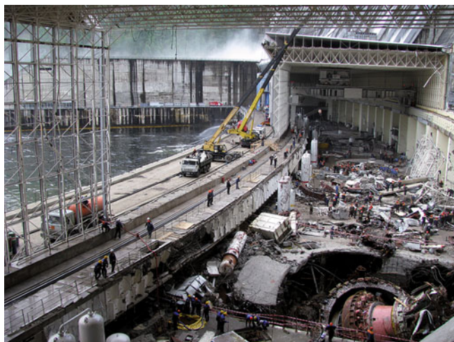
Рис. 1. Разрушенный машинный зал Саяно-Шушенской ГЭС (17 августа 2009 г.)
