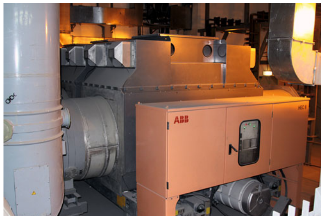
Рис. 2. Саяно-Шушенская ГЭС. Генераторный комплекс выключателя НЕС-8С (ток отключения 210 кА)
