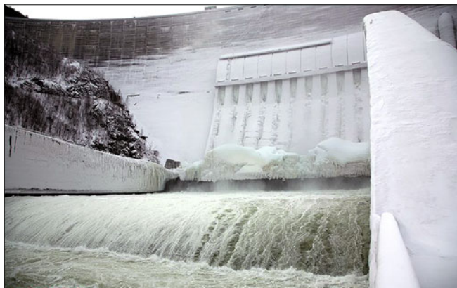
Рис. 4. Обледенение водосбросной части плотины и эстакады Саяно-Шушенской ГЭС при работе в зимних условиях (12 января 2010 г.)
