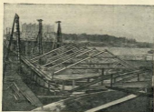
Фиг. 68. Перекрытие теплицы (справа фотографии) и установка стоек круглыми колодцами (справа снимка).
