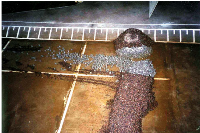
Рис. 2. Замыкание прорана кубами массой 13 т при расходе реки 1090 м 3 /с. Виден вынос отсыпаемого поверх кубов камня крупностью 12 – 36 см
