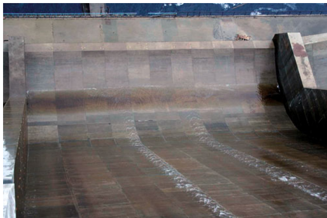
Рис. 1. Состояние центральной секции водосбросной плотины на 12 октября 2009 г.
