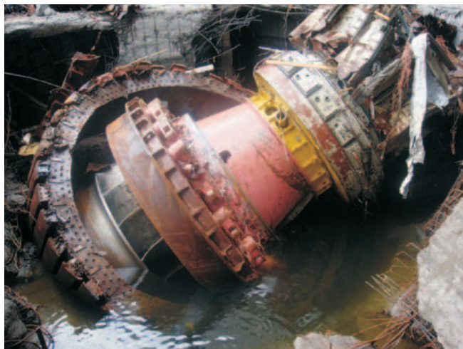
Рис. 1. Гидроагрегат № 2 после аварии
