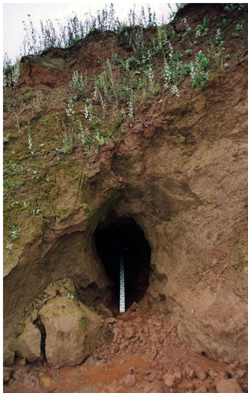
Рис. 3. Тоннель в суглинках (район с. Усть-Гаревая, Камское водохранилище, 2004 г.)
