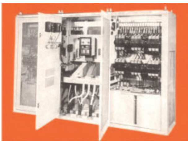
Рисунок 3. Внешний вид конденсаторной установки.
