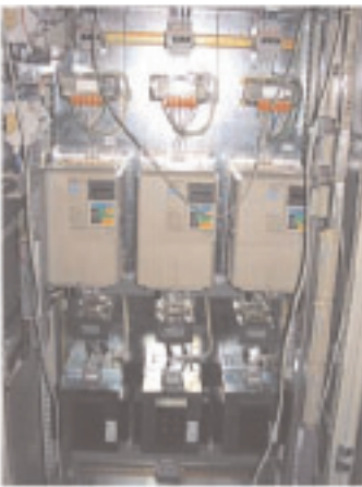
Рис. 3. Шкаф с частотными преобразователями 363BV-A4875-E привода ВСУ котла агрегата БКЗ-210
