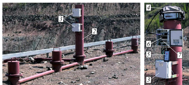
Рис. 2. Пример обустройства оголовков скважин с дистанционной КИА на грунтовой плотине:
