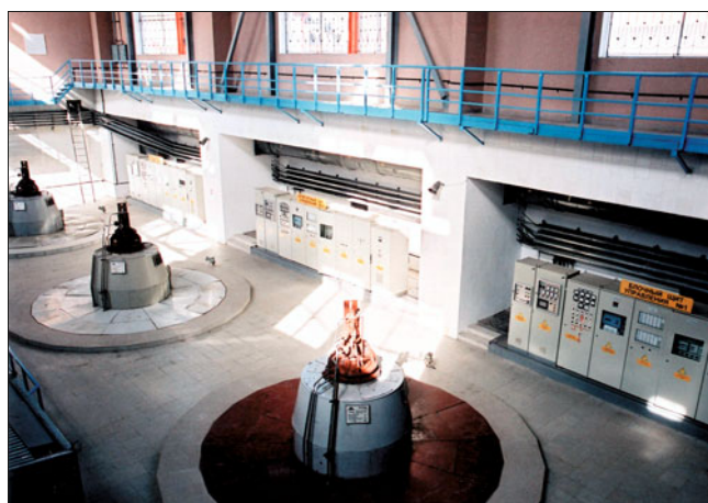
Рис. 7. Машинный зал здания ГЭС
