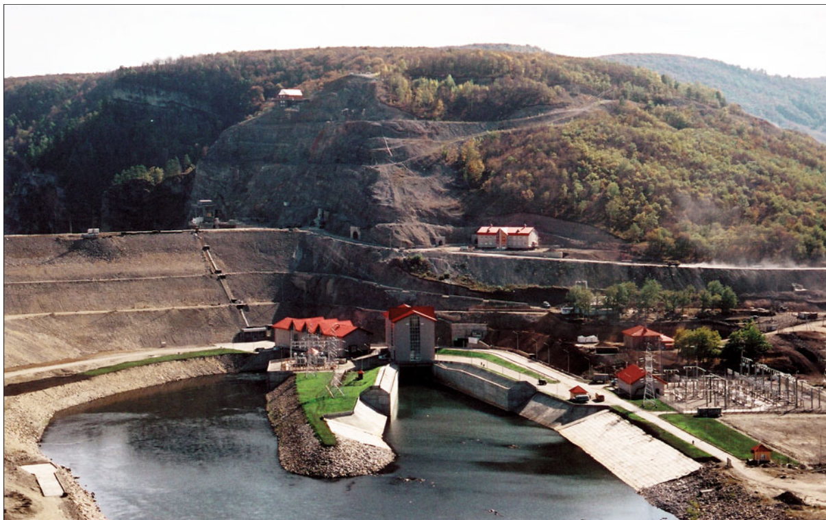
Рис. 4. Выходной оголовок и отводящий канал донного водосброса. Справа — ОРУ 110 кВ с ППУ, слева — здание ГЭС и трансформаторная площадка
