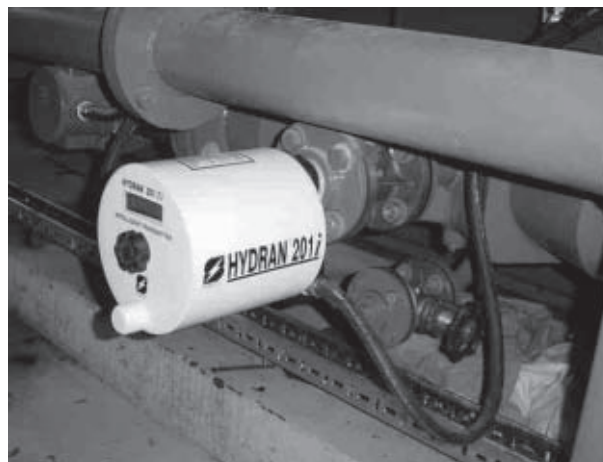
Рис. 1. Установка устройства типа HYDRAN 201j на баке трансформатора
