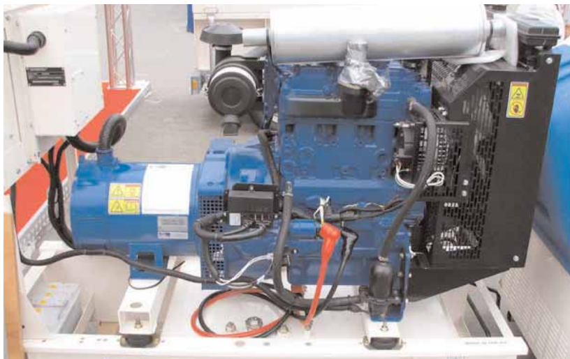
Фото 2. Дизельные электростанции FG Wilson.
