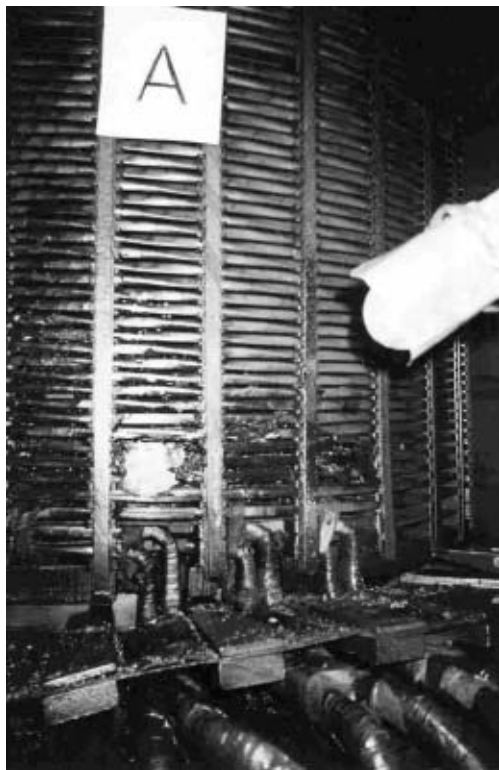
Рис. 2. Пример возникновения виткового замыкания в обмотке НН трансформатора типа ТДЦ-250000/220
