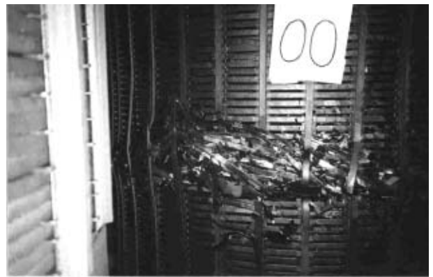
Рис. 3. Фотография ранее поврежденной в результате внутреннего замыкания общей обмотки 220 кВ на п/ст «Бугульма-500» одноступенчатого автотрансформатора 167 МВА/500/220 кВ
