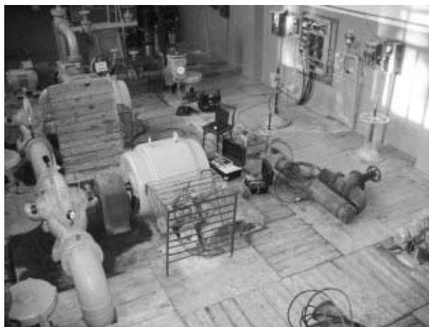
Энергоаудит насосного оборудования объектов водоканала Сочи
