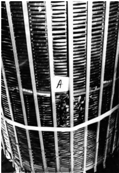
Рис. 1. Фаза «А» обмотки НН трансформатора типа ТДЦ-250000/220
