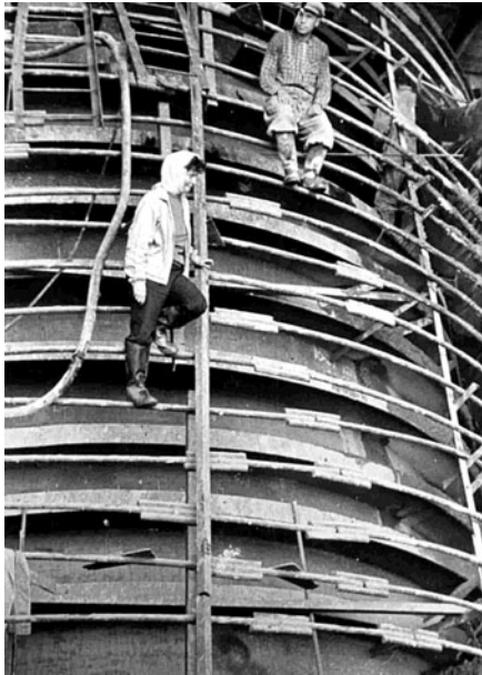
На водоводе Братской ГЭС
