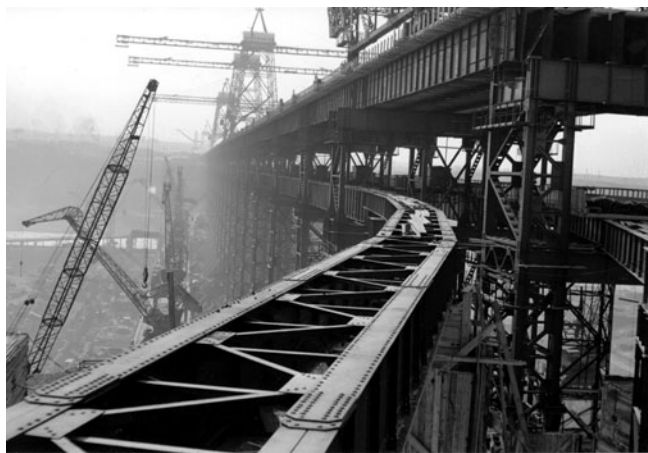
Стройка была оснащена высокоэффективным отечественным оборудованием — большой и малой эстакадами, двухконсольными и портално-стреловыми кранами и др.
