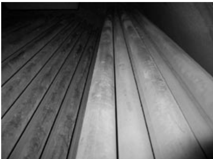
Трубки парового котла после промывки
