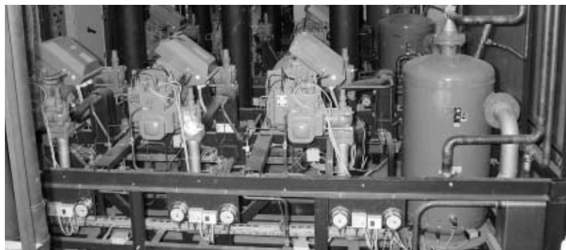
Морозильная установка, в которой работает 9 полугерметичных низкотемпературных винтовых компрессоров HSN8571-125Y
