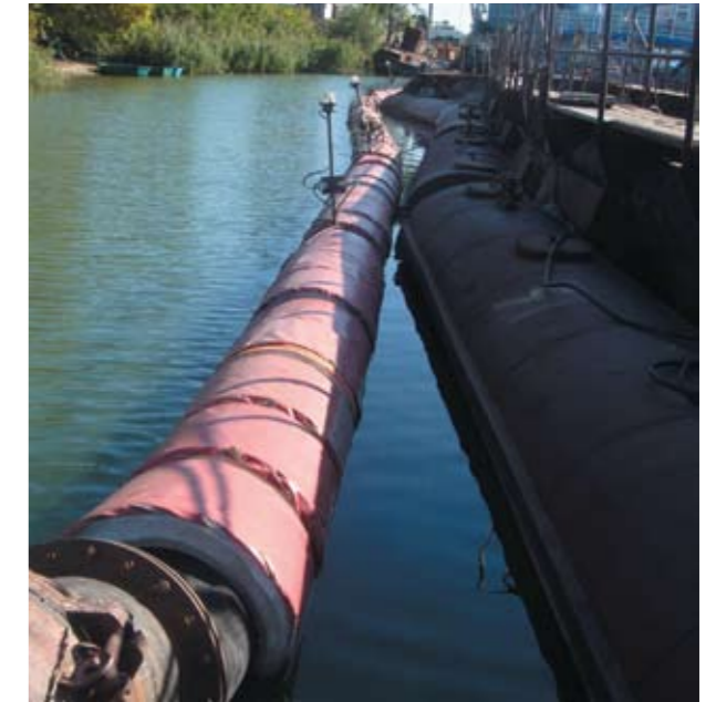
Рис. 3. Два плавучих грунтопровода диаметром 530 мм: металлический грунтопровод на понтонах и гибкий производства «Рассвет-К» позволяет перемещать гидросмесь повышенной концентрации
