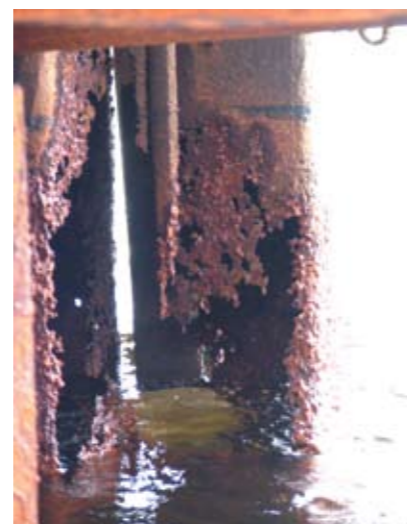
Рис. 1. Сквозное сооружение с коррозионными повреждениями в зоне переменного уровня
