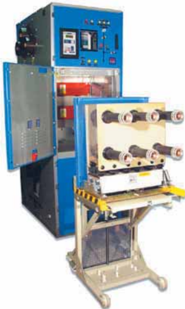
Рис. 4. Общий вид инвентарной тележки с KBЭ/TEL-10-25/1600 У2 в ремонтном положении
