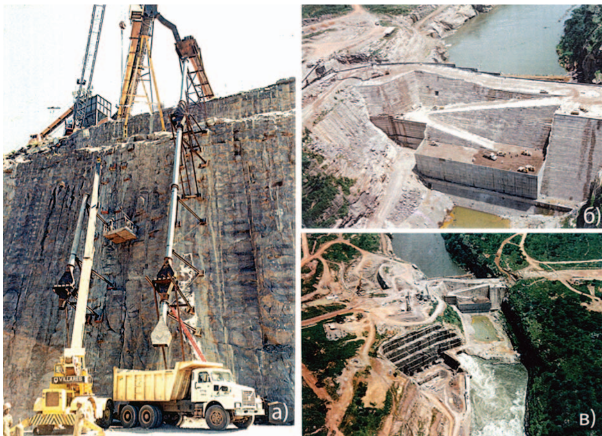
Рис. 8. Строительство ГЭС Капанда: а — подача бетонной смеси сбросом с правобережного бетонного завода; б — съезд в теле бетонной плотины; в — общий вид гидроузла
