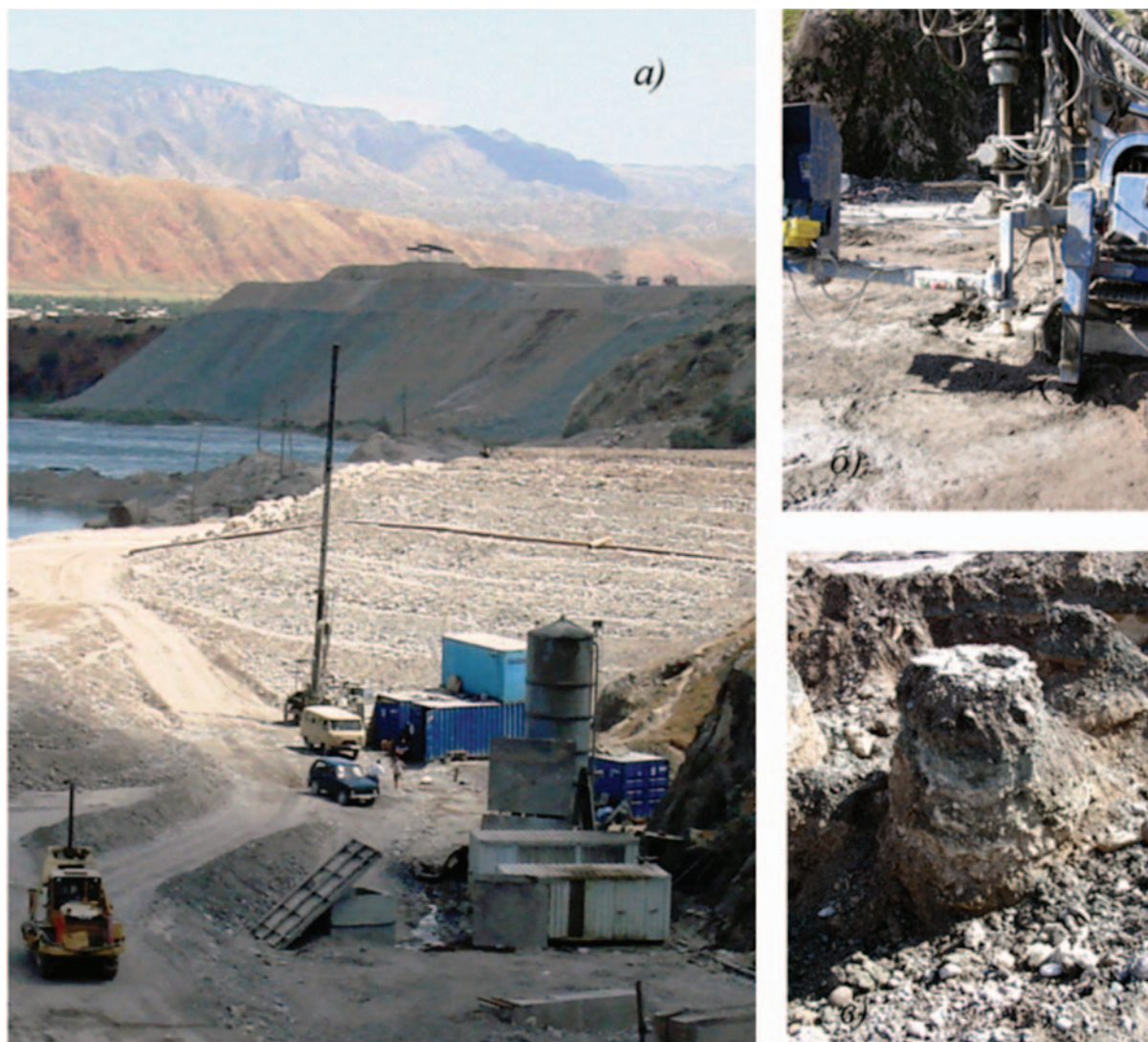
Рис. 1. Установка для закрепления слабых грунтов джет-граунтингом (Сангтудинская ГЭС-1): а — общий вид установки; б — бурные скважины; в — образец грунтоцементной сваи после джет-граунтинга
