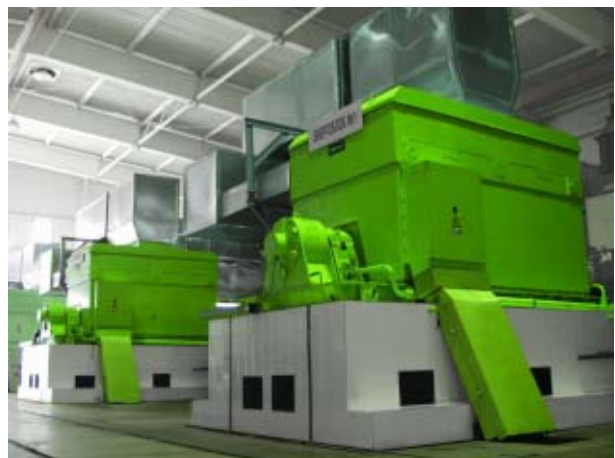
Турбогенераторы ТС-12-2ПУХЛЗ на Ленторском месторождении ОАО «Сургутнефтегаз»
