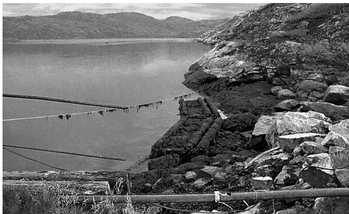
Рис. 3. Общий вид бетонной поверхности бычка здания ПЭС со стороны моря, в нижней части видны биообрастания баянусом
