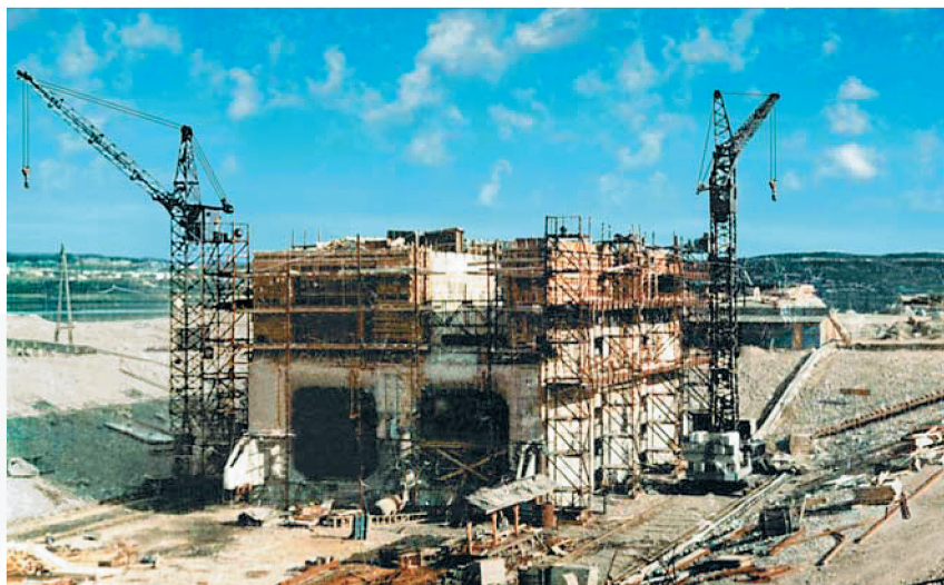
Рис. 1. Сооружение наплавного железобетонного тонкостенного (15 – 20 см) блока здания ПЭС из высокопрочного необрастающего бетона особовысокой морозостойкости
