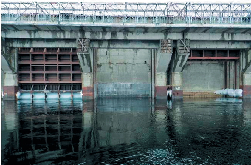
Рис. 1. Распорные балки Саратовской ГЭС: вторая слева отремонтирована; третья слева — не отремонтирована
