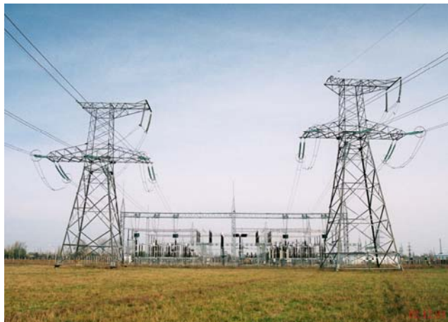
Подстанция 330 кВ Агджабеды
