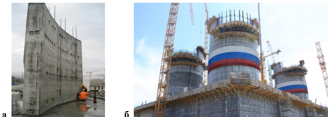
Рис. 1. Ледозащитные приспособления БОГТ «Беркут» месторождения Аркутун-Даги: а – опытный образец бетонного ледозащитного пояса; б – бетонный ледозащитный пояс
