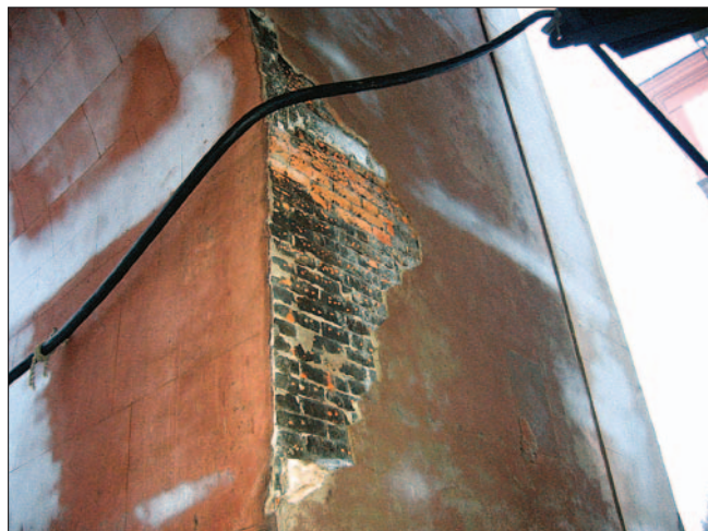
Рис. 8. Башни верхней головы. Локальное разрушение штукатурного слоя
