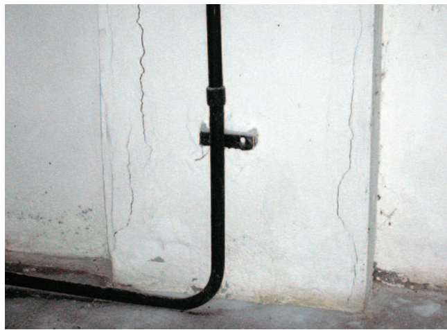
Рис. 2. Здание водоприёмника. Вертикальные трещины в колоннах, образовавшиеся в результате коррозии стальной арматуры
