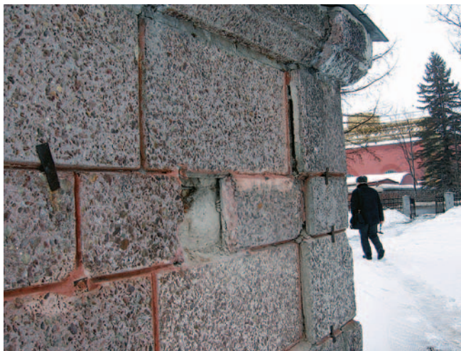
Рис. 3. Здание водоприёмника. Повреждение фасадов, вызванное увлажнением и размораживанием стен. Нарушено сцепление декоративной плитки со стенами, стальные анкеры корродируют
