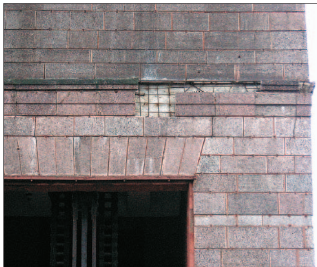
Рис. 6. Башни верхней головы. Ввиду опасности обрушения удалена облицовочная плитка и угловые камни
