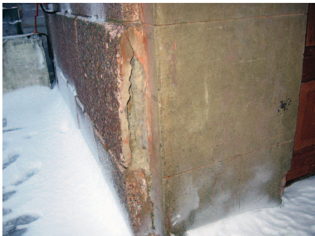
Рис. 7. Башни верхней головы. Разморожен кладочный раствор, нарушено сцепление облицовочной плитки со стеной
