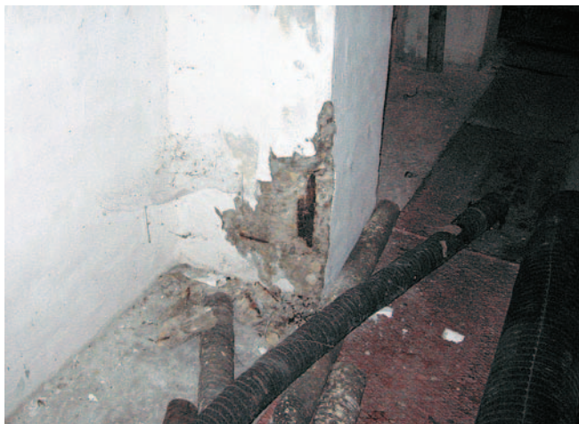
Рис. 1. Здание водоприёмника. Разрушение защитного слоя бетона колонн в результате коррозии стальной арматуры. Коррозия слоистая, толщина слоя продуктов коррозии достигает 4 мм. Полная карбонизация защитного слоя бетона
