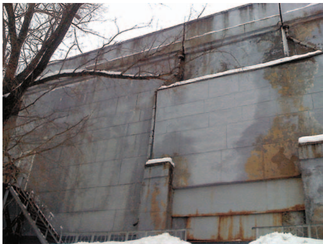
Рис. 9. Помещения механизмов нижних двухстворчатых ворот. Стоки с проезжей части моста увлажняют стены, усиливают морозную деструкцию штукатурного слоя
