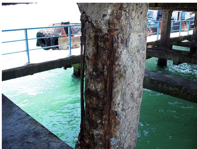
Рис. 2. Состояние железобетонных конструкций существующих пирсов
