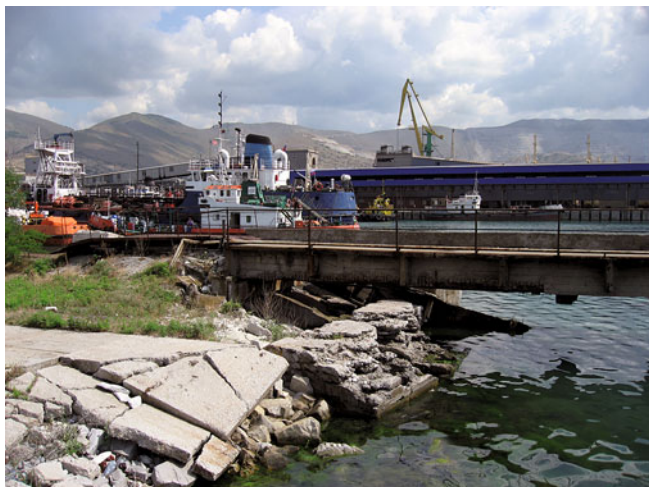
Рис. 2. Состояние пристани № 4 до начала реконструкции (2009 г.)
