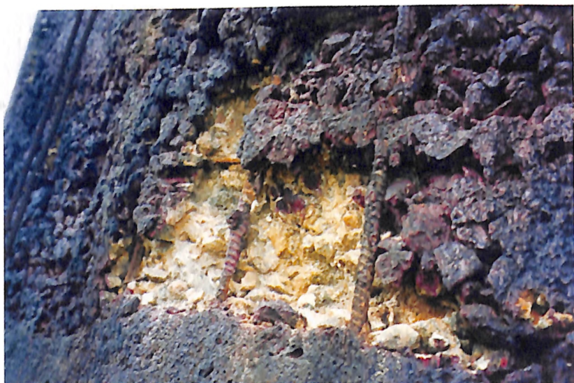
Железобетонный ствол дымовой трубы: крупнопористый бетон; следы выхода серной кислоты из-за недостаточной газоплотности футеровки
