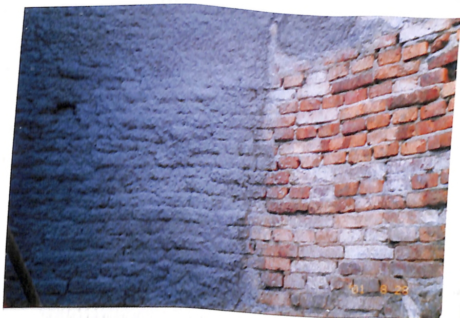
Покрытие футеровки дымовой трубы материалами серии ЭМАКО (к статье Затворницкой Т.А., Магитон А.С., Козлова Г.Н.)
