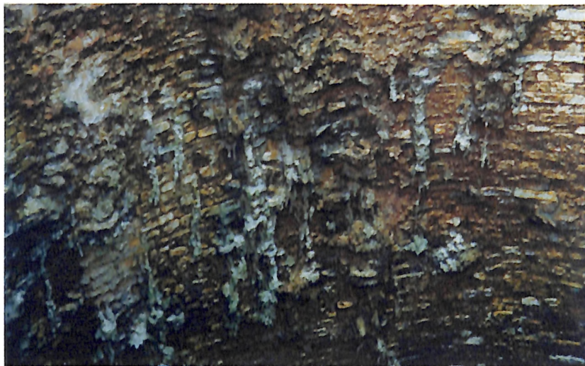
Состояние кирпичной кислотостойкой футеровки дымовой трубы, подвергшейся сульфатной коррозии (топливо — газ, мазут): продукты сульфатной коррозии в виде наростов на поверхности футеровки; разрушение кирпича до 50 — 100мм с потерей прочности раствора кладки
