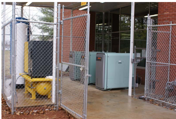
Азотные дожимные компрессоры WP4325 ComSilent, воздушный компрессор WP3215 ComSilent в системе воздухоразделения (штат Алабама, США)
