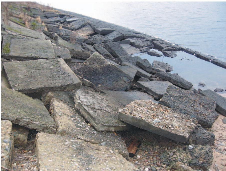
Рис. 12. Повреждения плит дамбы в результате размыва грунта
