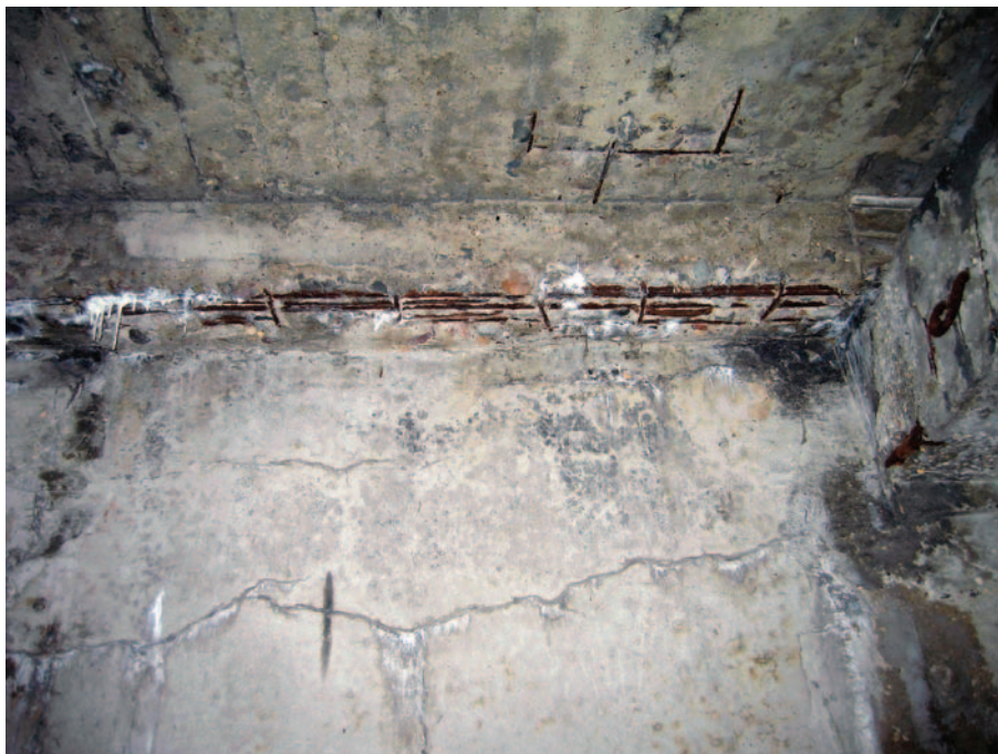
Рис. 8. Коррозия арматуры и размораживание бетона в тротуарных плитах, бортовой балке, подкосах и контрфорсах; горизонтальная фильтрующая трещина в стенке межшлюзового пространства
