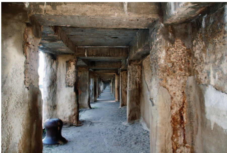
Рис. 11. Повреждения внутри галереи причала: размораживание бетона, трещины, отделение защитного слоя бетона с оголением корродирующей арматуры
