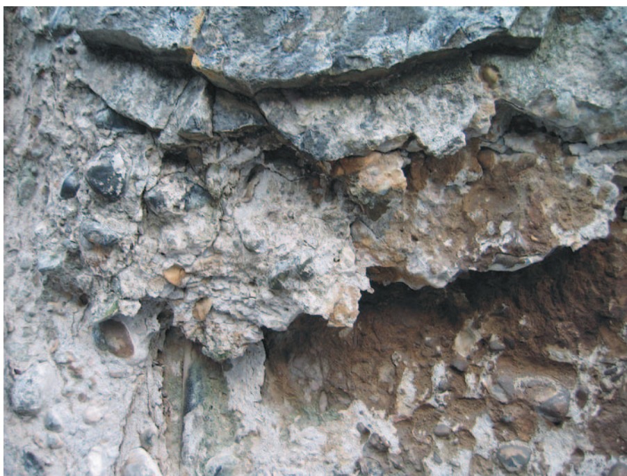
Рис. 6. Разрушение ремонтного торкрет-бетона и монолитного бетона до оголения стальной арматуры на глубину до 15 см в стенке камеры шлюза
