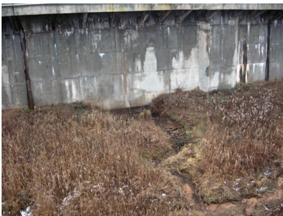
Рис. 9. Вертикальные трещины в стенке межшлюзового пространства с выносом извести, ржавчины и органических продуктов черного цвета над провалом в грунте
