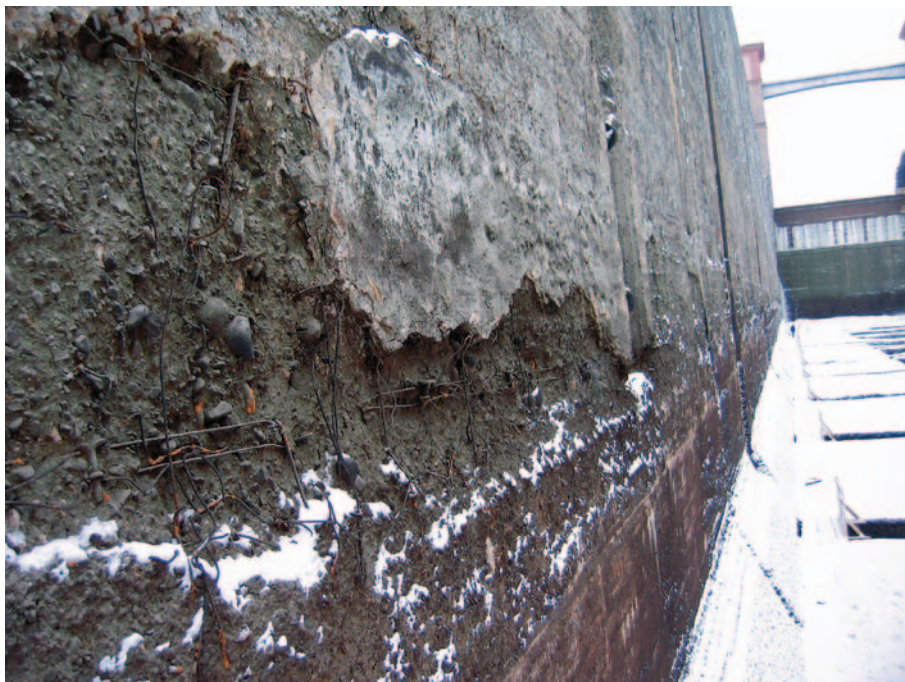
Рис. 3. Обнажение и обрыв проволочной арматуры плит-оболочек при глубоком повреждении бетона
