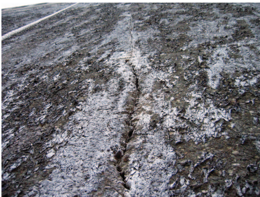
Рис. 4. Вертикальная трещина в стенке камеры шлюза, потеки отсутствуют, трещина не сквозная
