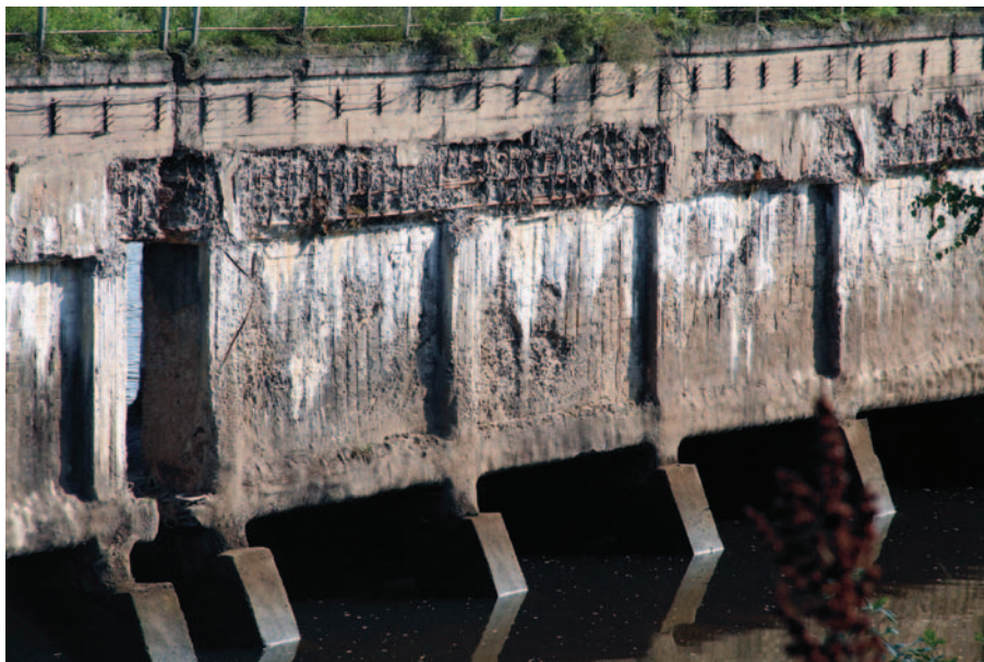
Рис. 10. Повреждения бетона в конструкциях причальных галерей в результате размораживания на глубину до 20 см с оголением стальной арматуры, коррозия арматуры от ржавчины до обрыва стержней
