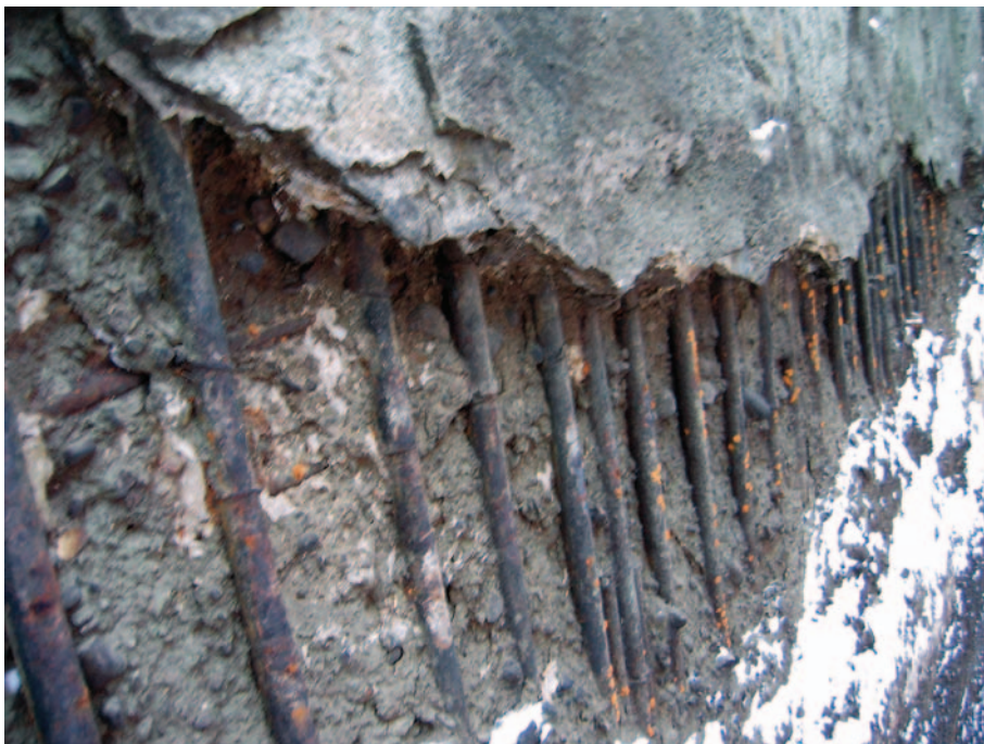
Рис. 2. Разрушение плит-оболочек и монолитного бетона до рабочей арматуры
