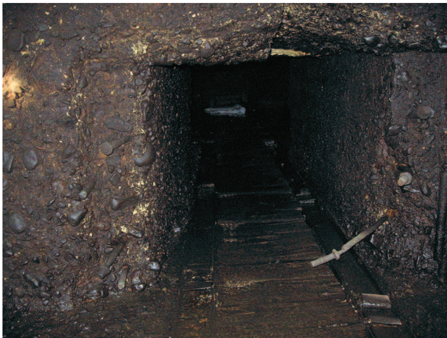
Рис. 7. Повреждения стенок водоводов на глубину до 7 см в результате выщелачивания, размораживания бетона и кавитации
