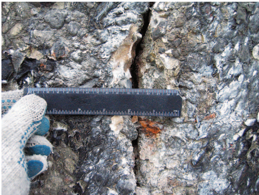
Рис. 5. Трещины в стенках межкамерного пространства шириной раскрытия до 10 мм, бетон вокруг трещины разморожен
