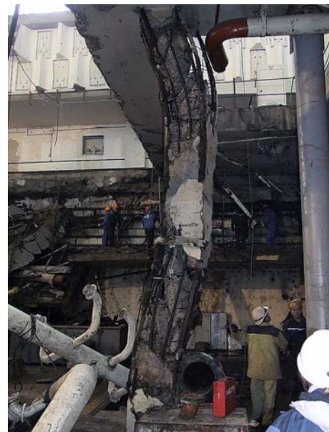
Рис. 6. ГА-8. Разрушенная колонна К1
