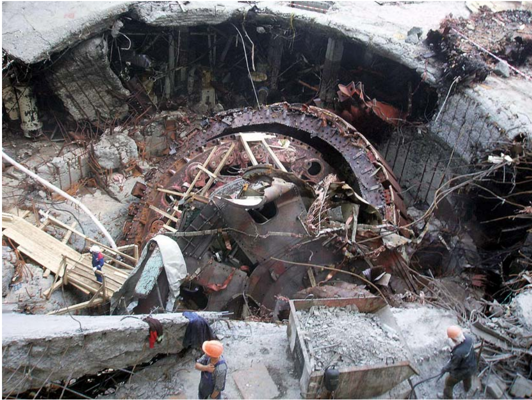
Рис. 4. Ударно-динамические воздействия при разгоне и подъеме ГА-2 привели к разрушению “бочки” генератора, фундаментов ротора и статора, плиты перекрытия на отм. 327,0 м
