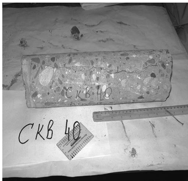
Рис. 3. Сквжина № 40, продольная трещина длиной 39 см на глубине 53,5 см от наружной поверхности керна
