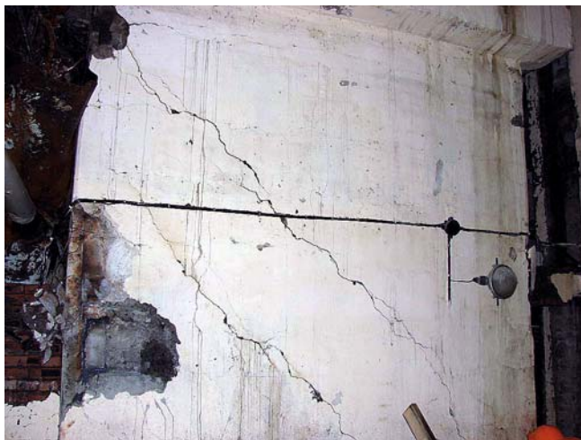
Рис. 5. ГА-2. Образование серии субгоризонтальных и наклонных трещин раскрытием от 1 до 7 мм в колонне КГ1 в отм. 319,8 – 327,0 м (вид со стороны ГА-1)
