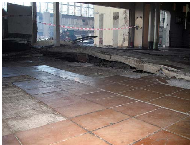
Рис. 9. ГА-7. Разрушение керамической напольной плитки по бетонной стяжке на отм. 327,0 м
