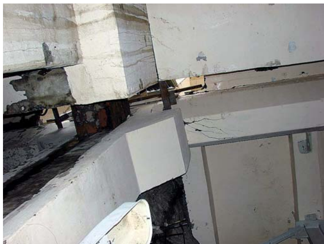
Рис. 8. ГА-2. Трещины и разрушения сборных железобетонных конструкций помещений в отм. 320,0 – 327,0 м
