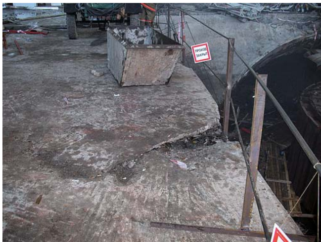
Рис. 10. ГА-8. Трещина в плите перекрытия
