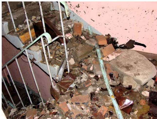
Рис. 11. Повреждения лестничных маршей под воздействием мощного водного потока, содержащего обломки строительных конструкций и сорванного оборудования
