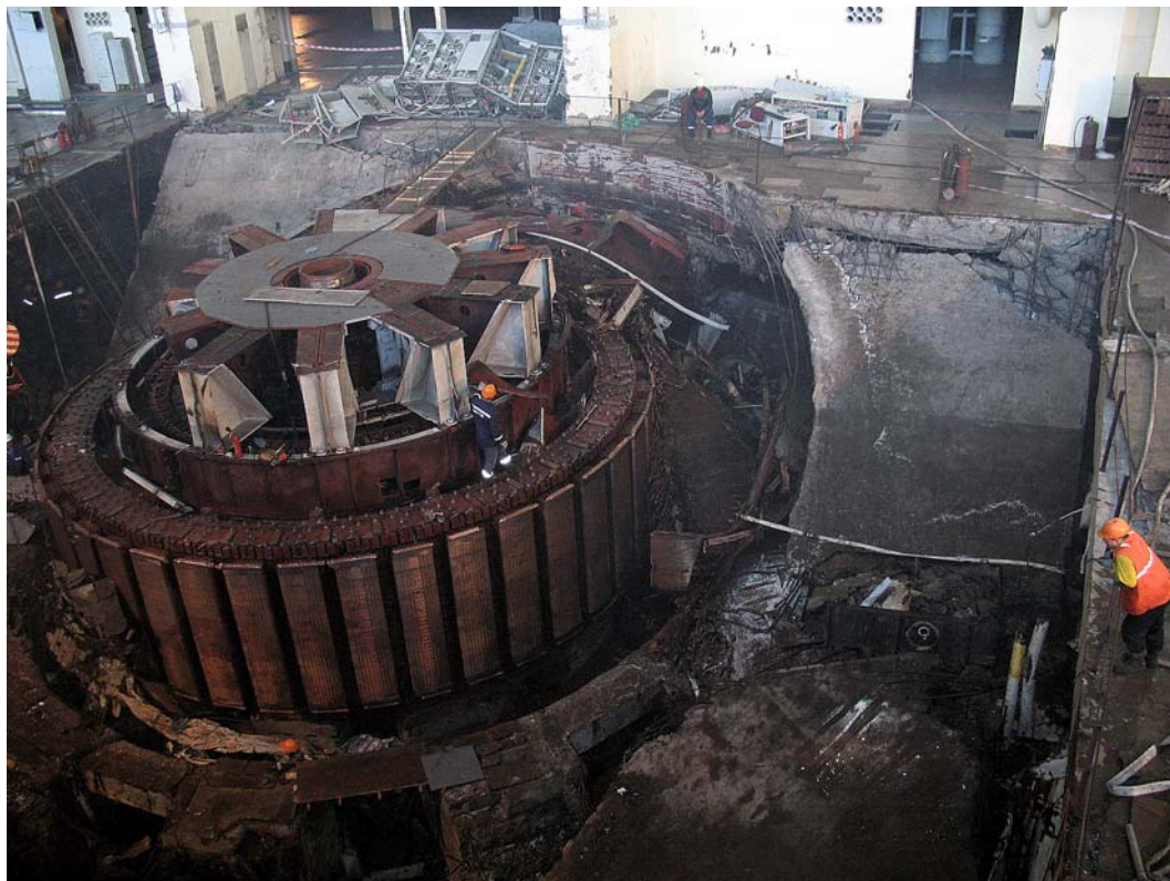
Рис. 7. Разрушение плиты перекрытия на отм. 327,0 м и “бочки” ГА-7
