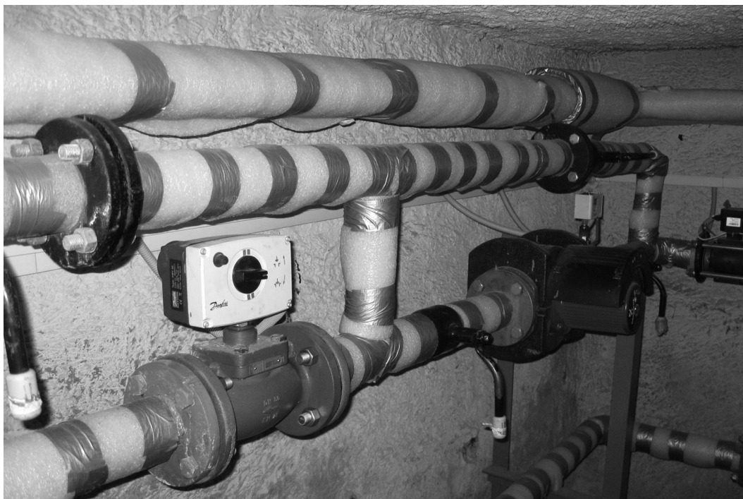
Рис. Фрагмент теплового пункта, собранного специалистами теплосети
