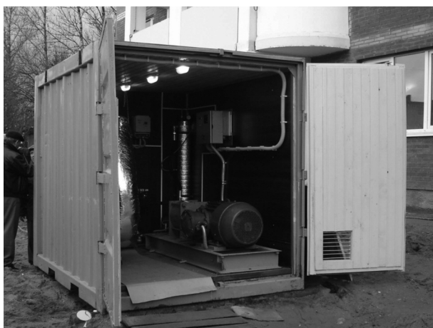
Рис. 2. Блочно-модульный тепловой пункт
