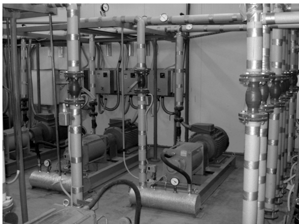
Рис. 1. Стационарный тепловой пункт
