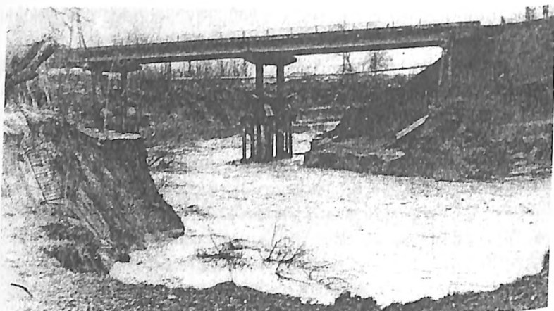
Рис. 3. Разрушенный мост в верхнем бьефе головного узла Талигулянской ГЭС-1.
